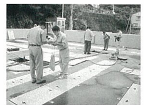
長崎浄化センター
